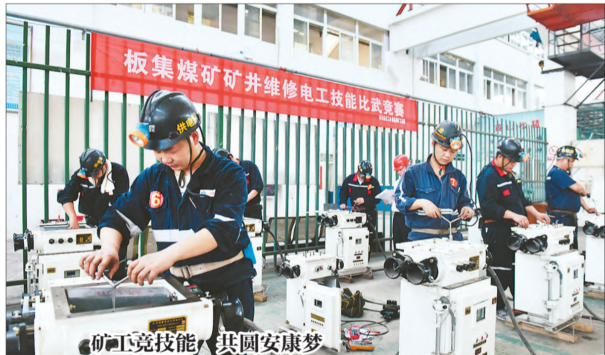
近日,由利辛县总工会主办、板集煤矿承办的2021年度“安康杯”竞赛暨“建功十四五·奋进新征程”煤矿劳动技能竞赛在板集煤矿如火如荼进行中,竞赛共有11个专业300余人参加。图为6月21日矿井维修电工比赛现场。 陈正飞/摄
